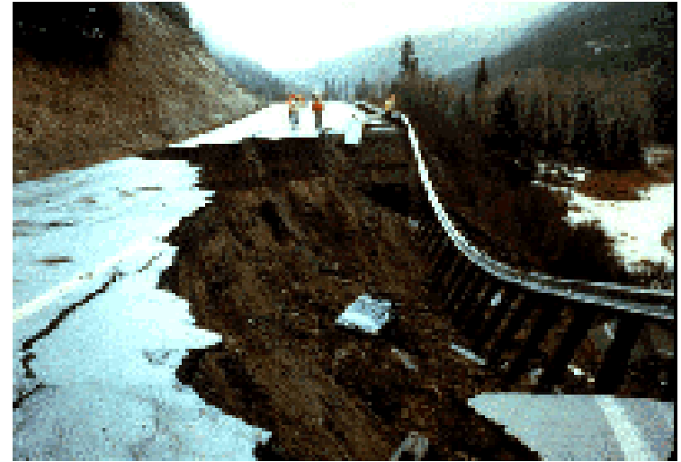
Оползень и «повисание» трубопровода
